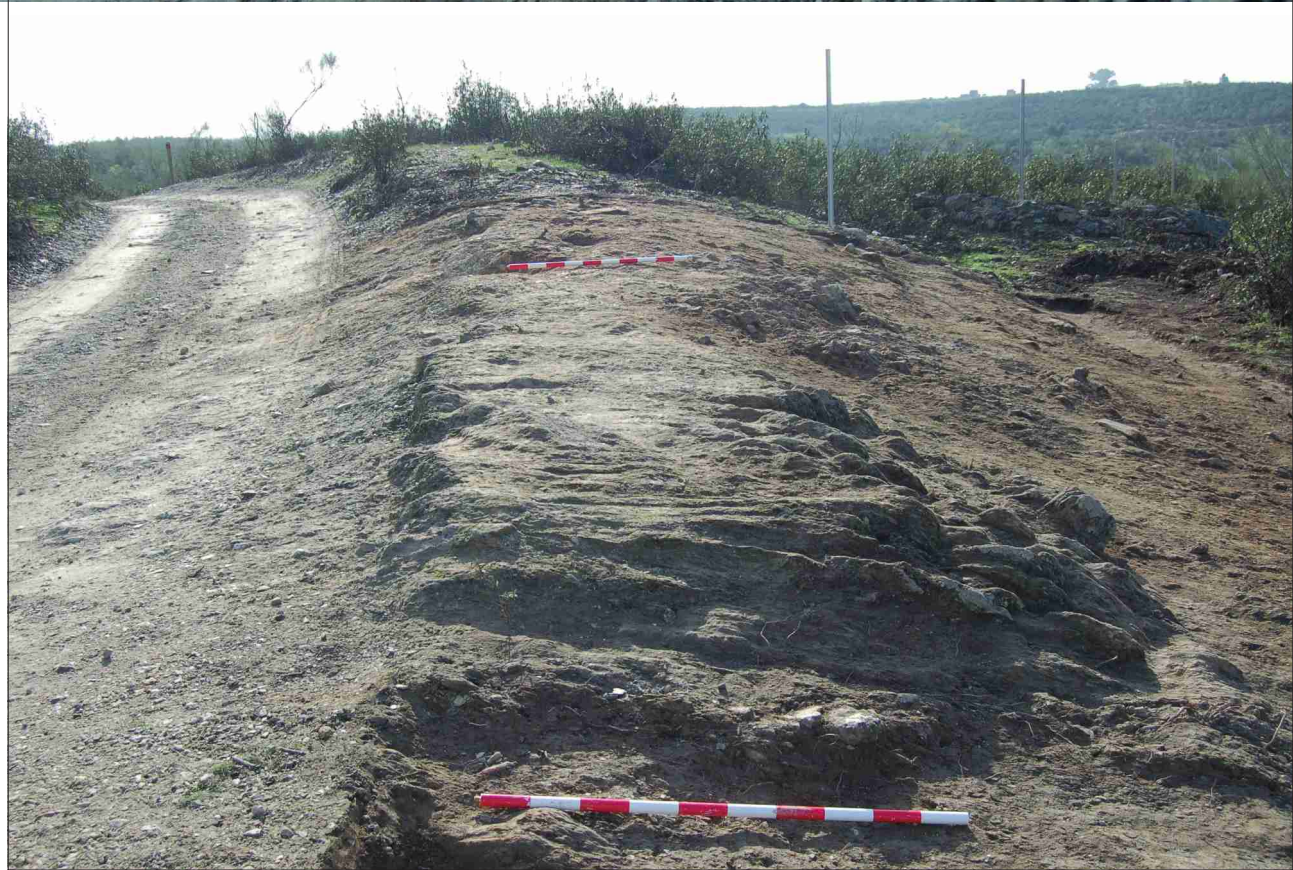
Fig. 6. Entalle oriental del cajeadado y restos de abombamiento en la roca natural, cortados por el trazado del camino actual.
